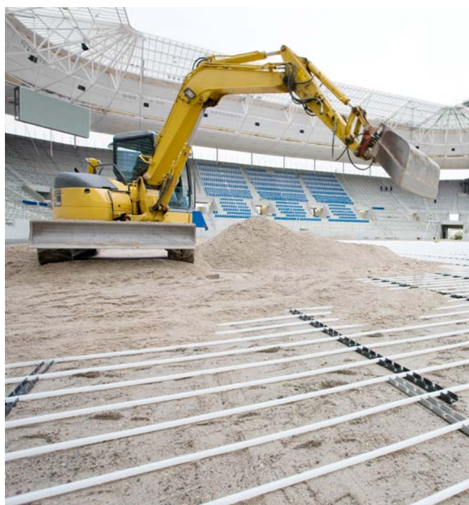
Sl. 8-43 Grejanje travnatih površina
